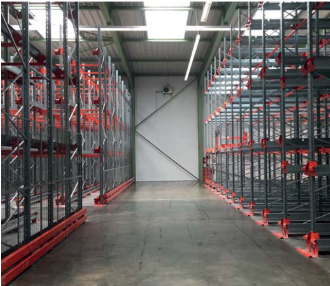
Kanallager vor Erstbestückung
